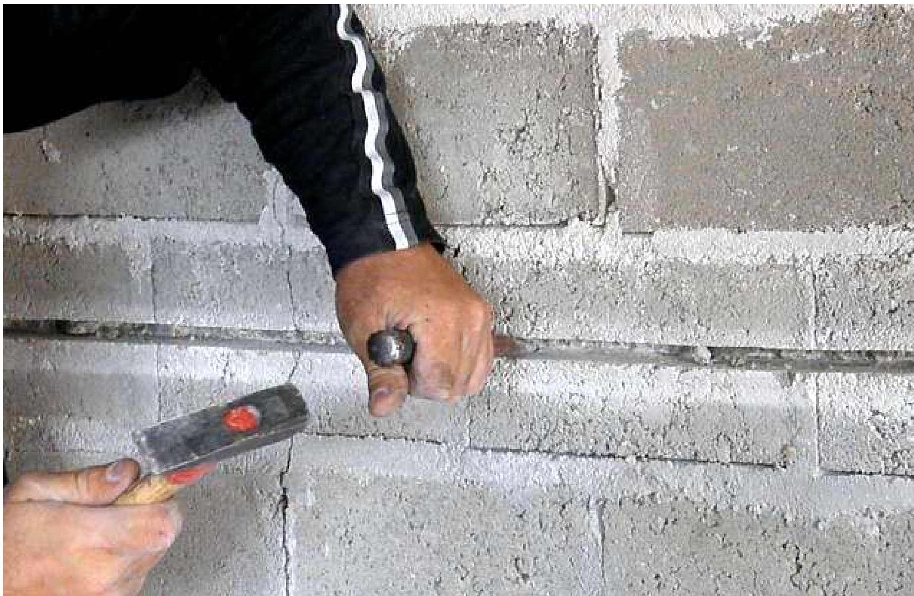
3. Wyrównać wewnętrzną ściankę szczeliny z pozostałości po frezowaniu korzystając z przecinaka i młotka
